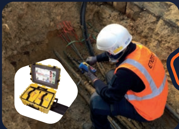
Identificación del cable adecuado
